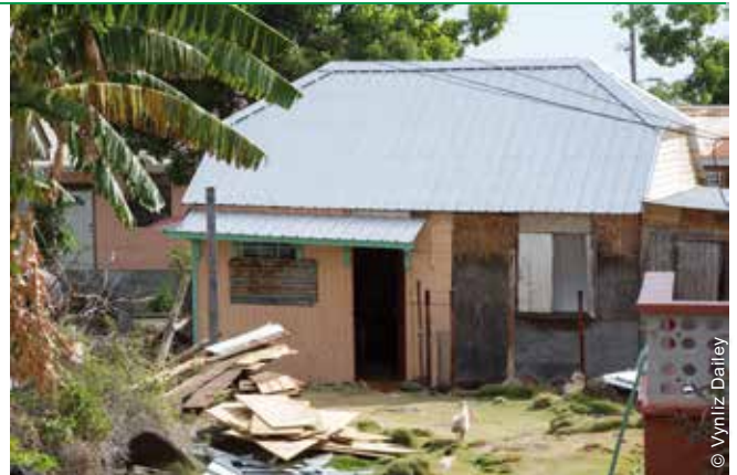
Aunque los techos se repararon conforme al código en vigor, no se incluyeron mejoras estructurales, ni tampoco componentes relativos al agua, el saneamiento y los medios de subsistencia.
