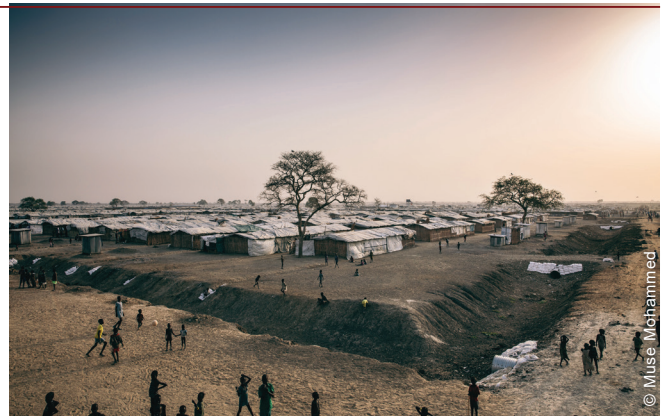
Les travaux d'aménagement du site se sont inspirés du système néerlandais de « polder ». Ils ont impliqué la construction de fossés de drainage de 28 m 2 divisés en sections, de bermes, de bassins de rétention et de pompes à grand débit pour évacuer l'eau.
